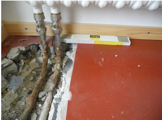
Bild 2: von außen korrodierte Heizungsrohre
